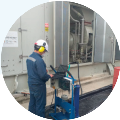
Servicio de filtración
